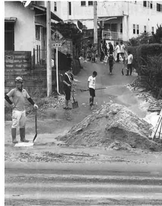
県道まで流れた土砂（7月7日、上条地区）
