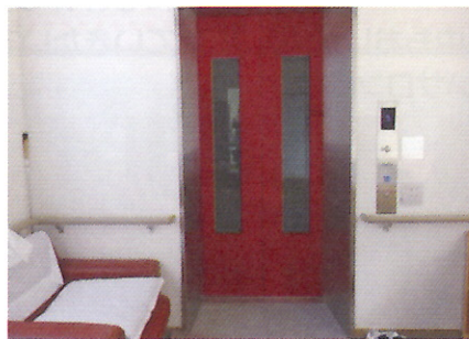
新設のエレベーター
