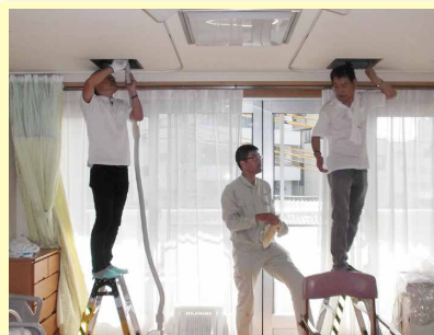
電気設備清掃及びその点検
